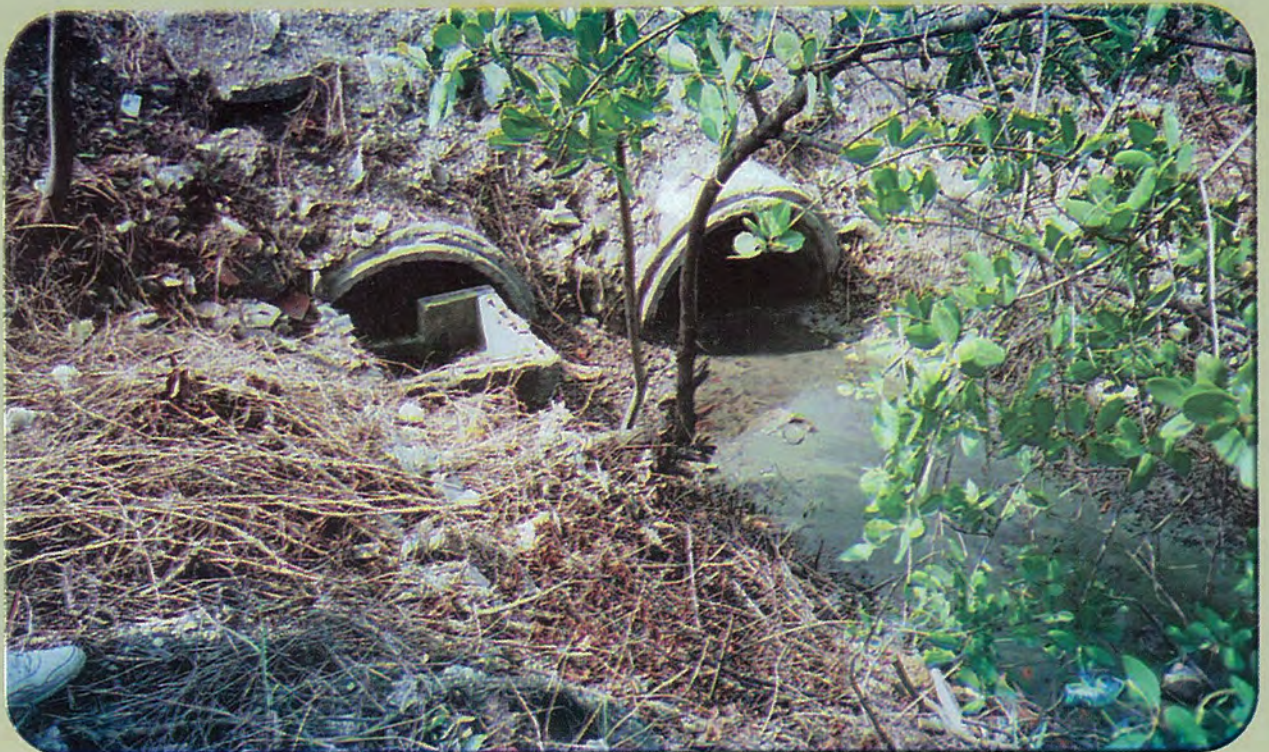
Alcantarillas en sectores de manglar
